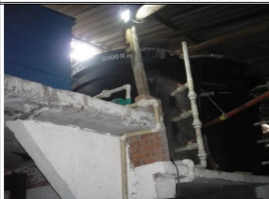
Foto No. 5 Sistema de tratamiento de ARnD.
