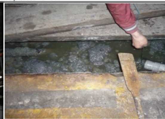
Foto No. 6 Trampa de grasas.
